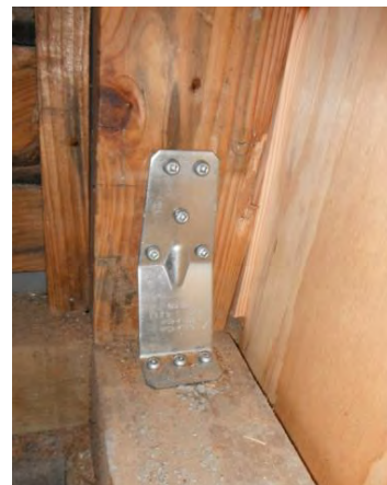
金物による補強
