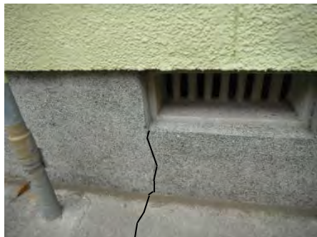
○基礎のクラック
