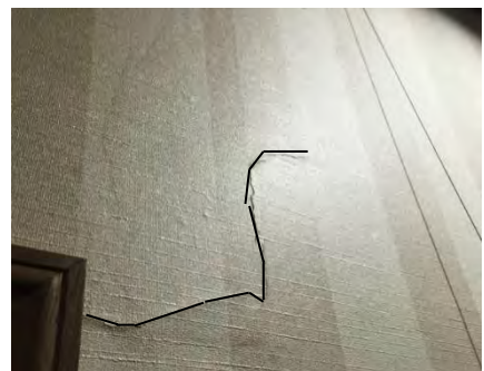
○クロスの割れ
